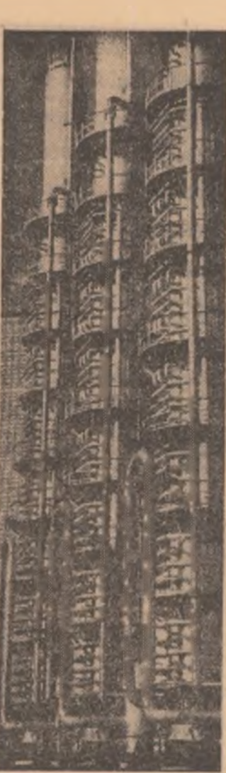
Combinatul chimic din Tg. Mureș. Instalația de acid azotic
