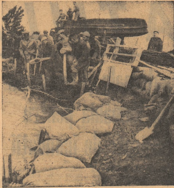
Șoseaua Brăila—Galați, km. 19: încă un dig de prevenire. Muncitori și soldați lucrează cu un singur gând: „Va scăpa întreprinderea frigorifică de furia apelor?”
