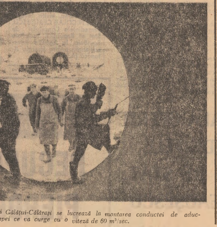
Pe șantierul sistemului de irigații Gălbăni-Căldărași se lucrează la montarea conductei de aduc- țune a apei ce va curge cu o viteză de 60 m/sec.
