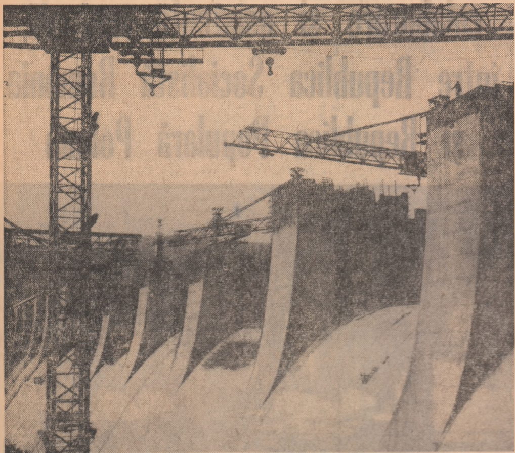
Zidul de beton ridicat in calea Dunării, la Porțile de Fier Foto: O. PLECAN
