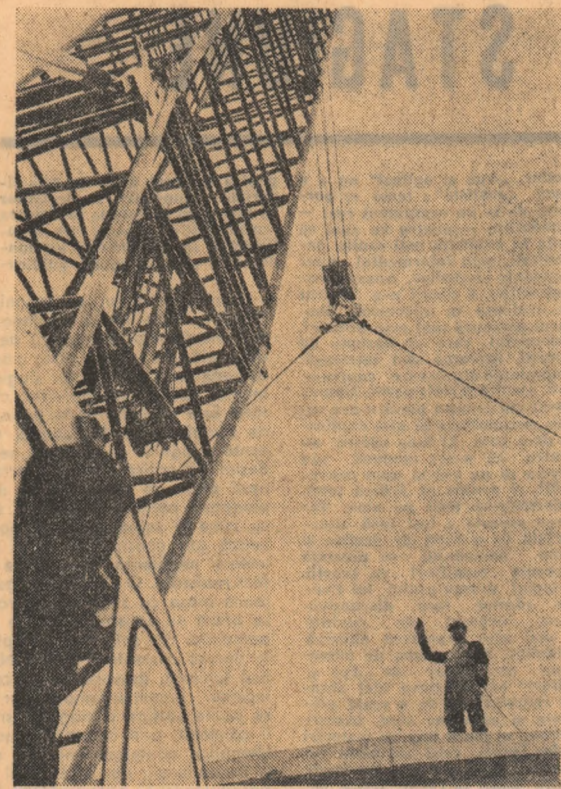
Pe șantierul viitoarei fabrici de utilaj terasier de la Buzău. Foto: PAVEL TINJALA
