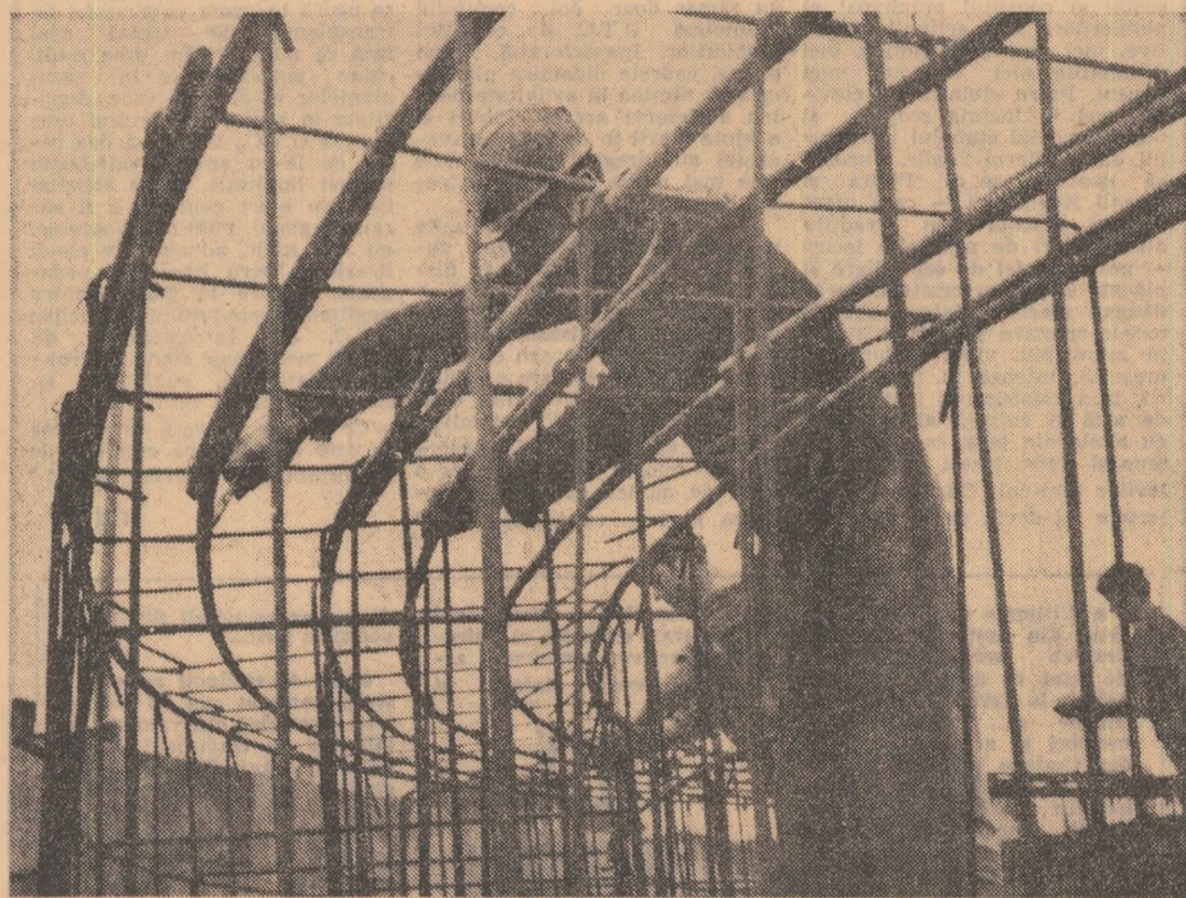
Au început lucrările la etapa a III-a de dezvoltare a Combinatului de îngrășăminte chimice din Valea Călugărească. Se lucrează fără întrerupere la fundațiile instalației de fosfat dicalcic. Fierarii betonării din echipa lui Gheorghe Birlă au început și ei să înfăptuească dantelăria de armare a vitelorlor silozuri.
