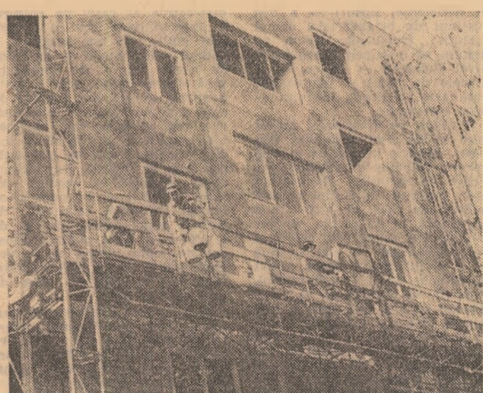
Șantierul Scolii profesionale M.I.U. Oradea, „Zidarii” gospodărituri cu grijă fiecare cantitate de mortar, execuții tencuiei în straturi uniforme respectînd indicațiile tehnologice”. O lozincă, un îndemn, o chemare la care tinerii, toți constructorii șantierului 2 a T.C.L. Oradea, răspund în fiecare zi pe schelele obiectivelor la care lucrează. În tot acest an ei s-au situat sub consumurile specifice de ciment planificate, nerit — printre altele — pentru care define loc 1 pe țară între întreprinderile care construiesc obiective social-culturale.
