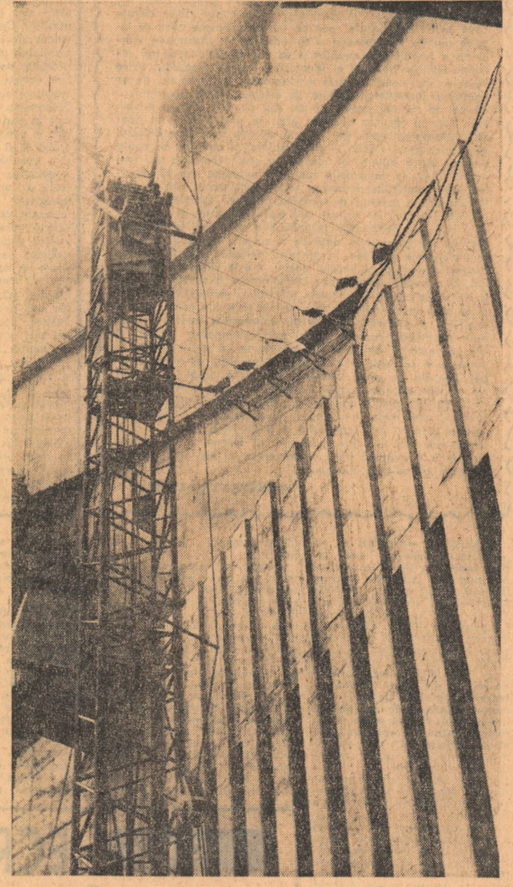
Fostul muncitor topograf Vasile Rodina a debutat în calitate de inginer odată cu prima cupă de beton turnată la temelia acestui baraj de la hidrocentrala Tarnița, pe Someș. Priviți cum arată barajul astăzi și nu vă va fi deloc greu să vă imaginați statura tînrului inginer. Foto: ȘT. WEISS
