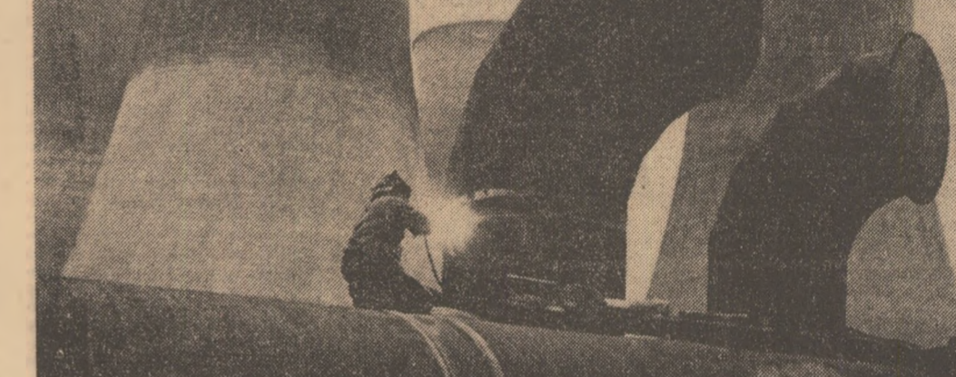
R. P. MONGOLA. — Imagine de la Combinatul de materiale de construcții din Ulan Bator
