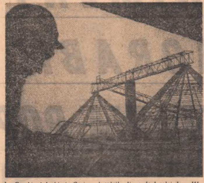
La Combinatul chimic Craiova lucrările din cadrul celei de-a III-a etape de dezvoltare sînt în plină desfășurare
