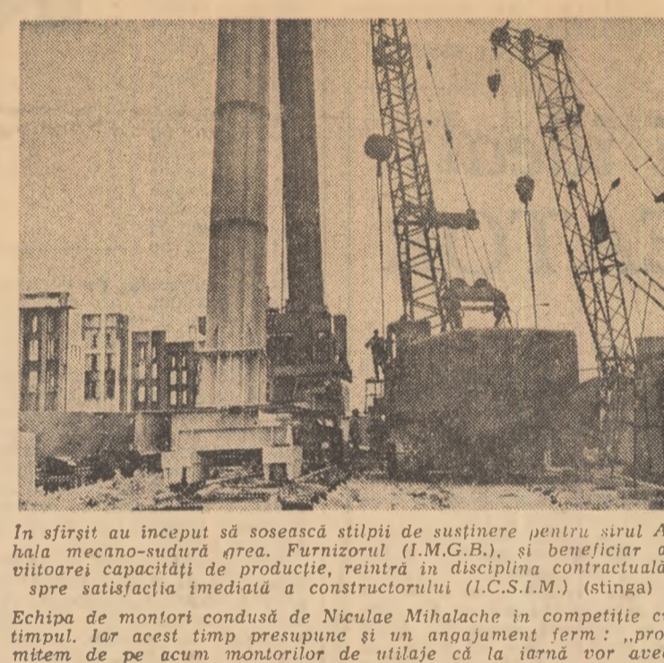
În sfârșit au început să sosească stâlpii de susținere pentru șirul A, hala mecano-sudură grea. Furnizorii (I.M.G.B.), și beneficiarul (I.C.S.I.M.) (stînga) Echipa de montori condusă de Nicolae Mihalache în competiție de timp...
