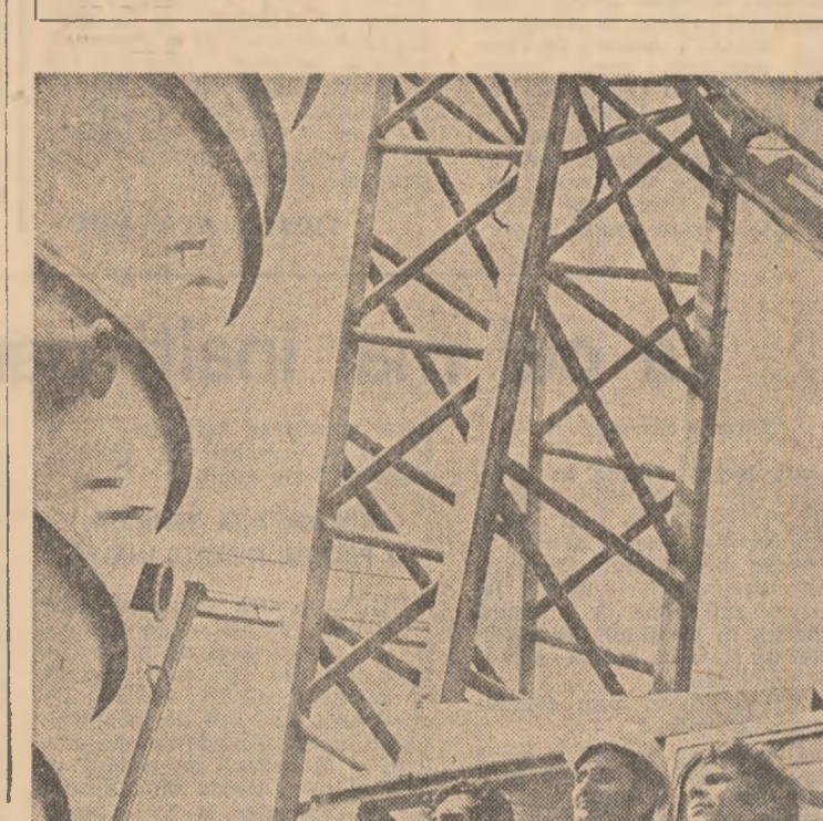
Stefan Lăcătuș, Ion Popa și Octavian Rîșnoaveanu — trei tineri macaragi care au contribuit la înălțarea coloanei de sinteză
