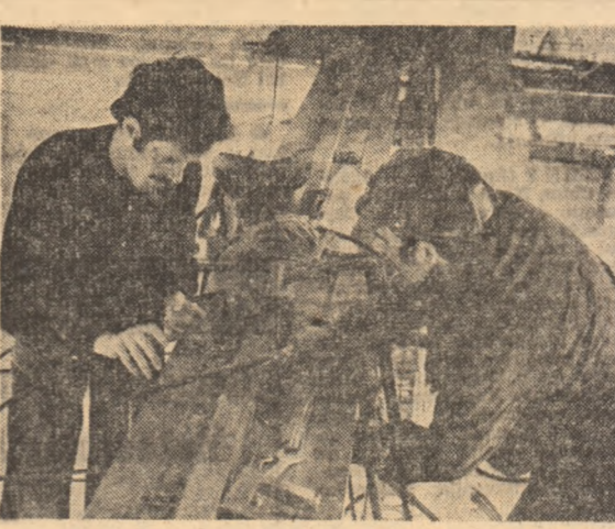
Atenție și precizie - caracteristici ce se impun chiar și atunci când se lucrează la fixarea limitelor podurilor rulate. Lăcătușii mașinilor Mircea Păunescu și Victor Dragomir, de la Întreprinderea de tractoare și mașini agricole din Craiova, lucrând pe șantierul construcției halei monobloc.
