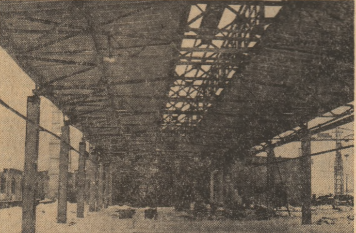
Se lucrează, așa cum nu se vede, se lucrează, acolo unde radiatoarele sînt în priză, iar acolo unde ar trebui făcute închiderile de hală, se invocă mai bîntul argument — starea timpului
