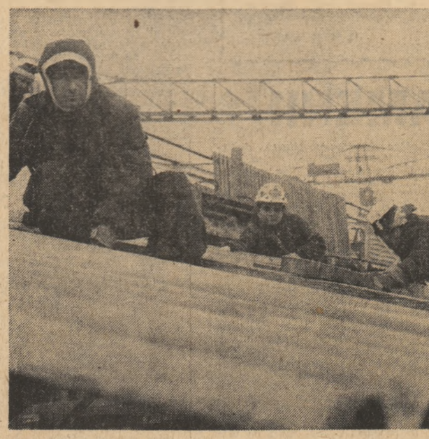
La Giurgiu, pe acoperișul halei principale a combinatului chimic, șeful de echipă Dinu Zamfirescu, alături de Pavel Gană, Marin Măneag și Florin Pană, tineri constructori, lucrează la colta maximă. Într-o vreme a apropierii de vară, luna mai însemnă în orașul de pe marginea Dunării timpul construcției, timpul verticalității. Timpul adevăratei tinereți. Tinerețea nu e o vîrstă care se inventează la Giurgiu. Este vîrstă, de fapt, a unui oraș care, trecut prin „furtive cadavre” ale istoriei, știe să întinerască prin fiecare zi, să renască prin fiecare tînar ce pune o piatră la temelia orașului de mîine.
