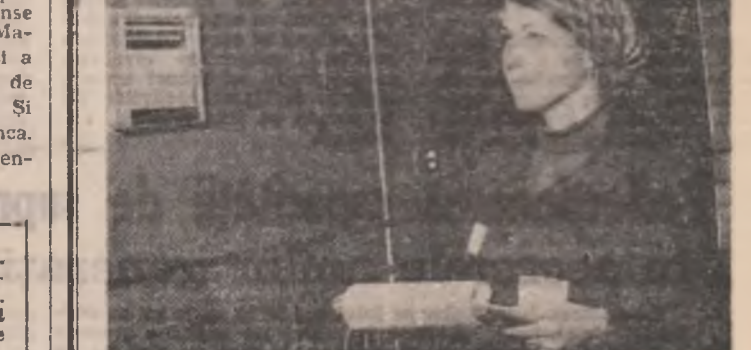
La camera de comandă a stației electrice, Elvira Zoto. Foto: GABRIEL LEANCU
