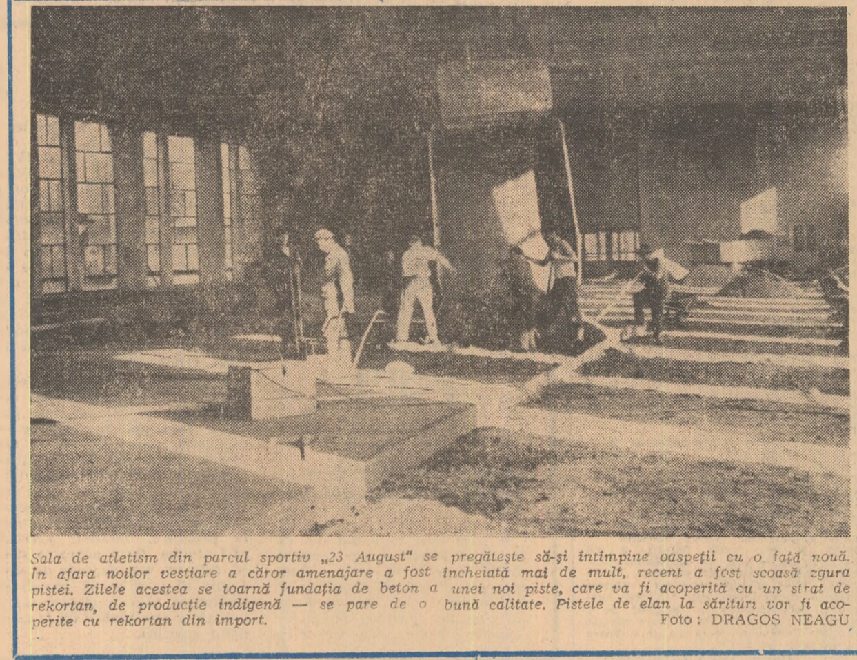
Sala de atletism din parcul sportiv „23 August” se pregătește să-și întâmpine oaspeții cu o față nouă. În afara noilor vestiare a căror amenajare a fost încheiată mai de mult, recent a fost scoasă zgrăvă pista. Zilele acestea se toarnă fundația de beton a unei noi piste, care va fi acoperită cu un strat de rekortan, de producție indigenă — se pare de o bună calitate. Pistele de elan la sărituri vor fi acoperite cu rekortan din import. Foto: DRAGOS NEAGU
