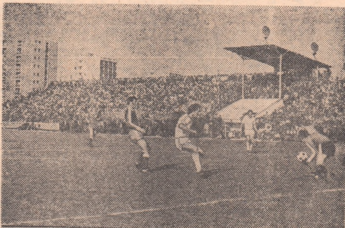
Modernizarea stadionului municipal Gloria — lucrare în curs — este cerută de afluzul tot mai mare al cetățenilor buzoieni la fenomenul sportiv
