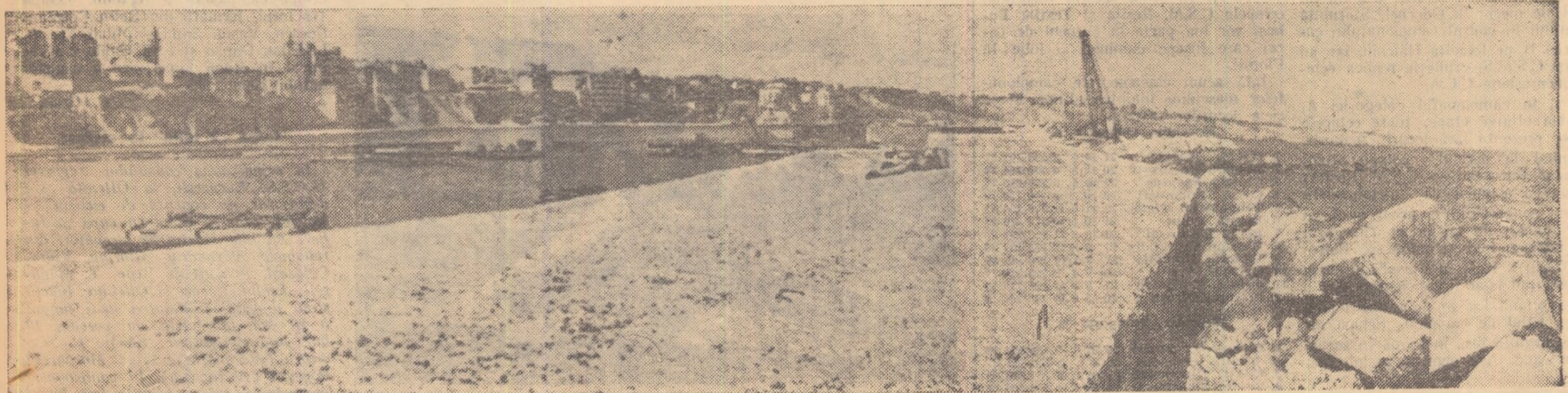
La poalele falezei și pe șosului constănțean, digul, în construcție, înaintea masiv în mare pentru a desăvîrși forma brîului de piatră, al noului port Tomis.
