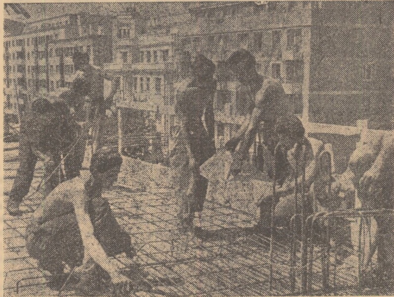
Fierarul betonist Alexandru Stan arată tinerilor sportivi din brigada sa sistemul de armare și unui planșeu.
