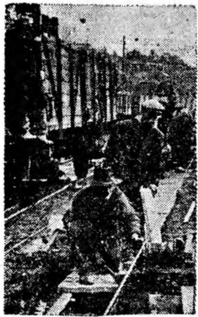
Dulgherul Bindea Vasile montează capace la noul canal de beton pentru scurgerea apelor dintre liniile ferate ale preparației Petrița.
