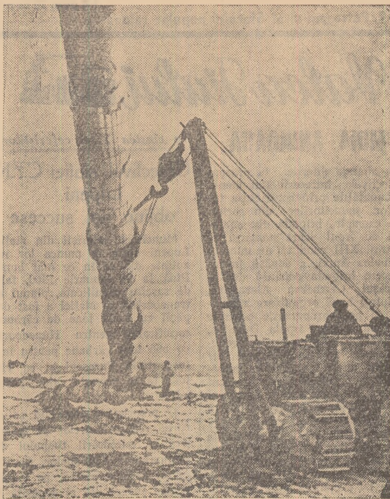
Pe unul din șantierele de construcție a conductei magistrale de gaze Șebelinke—Breansk.
