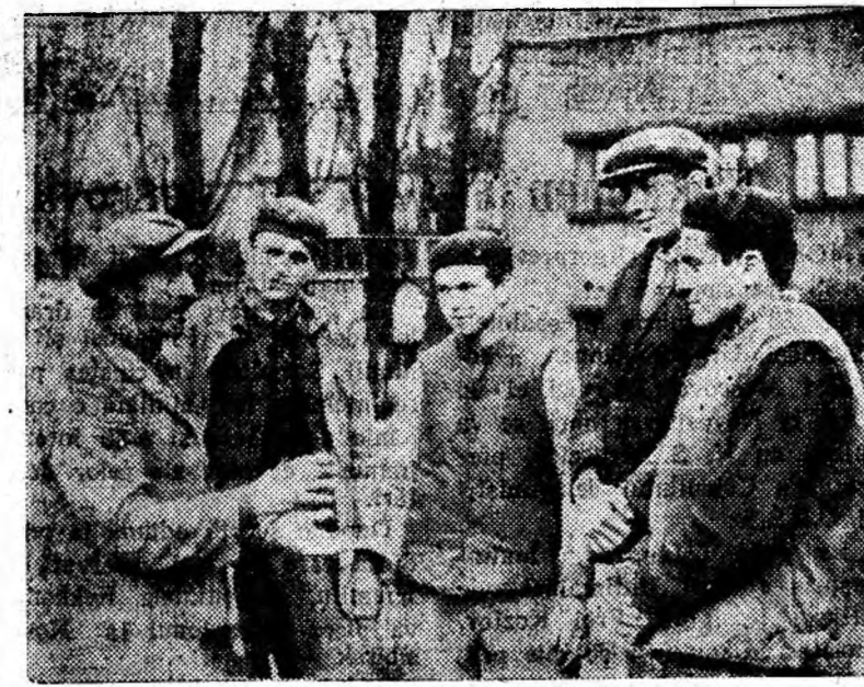
La pregătirile de iarnă care s-au făcut la mina Lupeni de către sectorul gospodăresc, o contribuție de seamă au adus-o zidarul din echipa condusă de membrul de partid Pop Alexandru. Repararea clădirii pufului Ștefan este doar una din lucrările executate de către această echipă. ÎN CLIȘEU: Zidarul Pop Alexandru (stînga) împreună cu echipa pe care o conduce.
