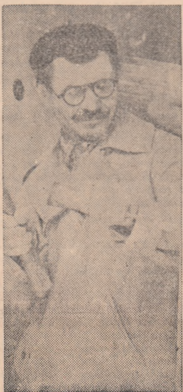
Timplarul Feniser Ioan este un muncitor conștiincios, care execută numai lucrări de bună calitate. Iată-l, în clișeu, lucrînd la montarea unui toc de fereastră pe șantierul noulor blocuri din strada Constructorilor — Petroșani.
