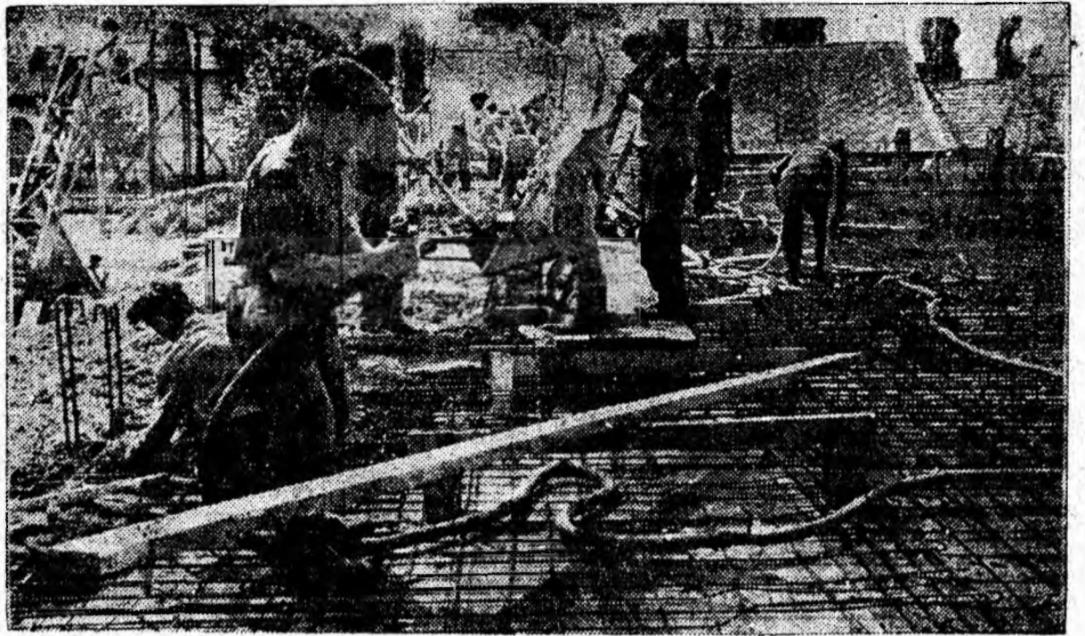
Construcția noii case de cultură din Petroșani înaintează mereu. Una din etapele însemnate ale construcției este „ieșirea din pămînt” și turnarea plăcii de beton a parterului. La această lucrare, o contribuție însemnată aduc fierar-betoniștii Ciungulescu Marin, Osvald Ion, Ursu Constantin care au montat armătura și dulgherii Giurgiu Nicolae, Popescu Gheorghe, Vișan Sotir, Gheorghe Ion, Obădan Grigore care s-au evidențiat în confecționarea cofraajelor.
