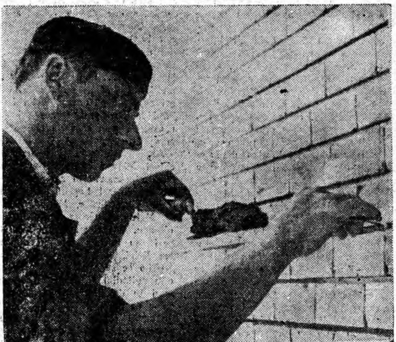
Pe șantierul Lupeni, constructorii execută un însemnat volum de finisaje exterioare. Iată-l în clișeu pe zidarul Kincses Andrei lucrînd la placarea fațadei blocului B 5 cu cărămizi ceramice.
