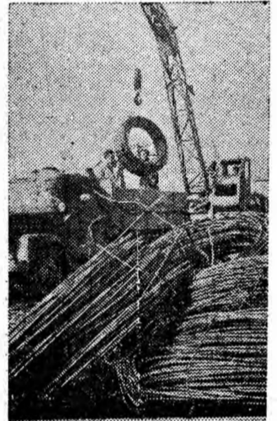
Aspect cotidian de pe șantierul Văli Jiului: se descarcă materiale pentru construcția blocurilor glisante.
