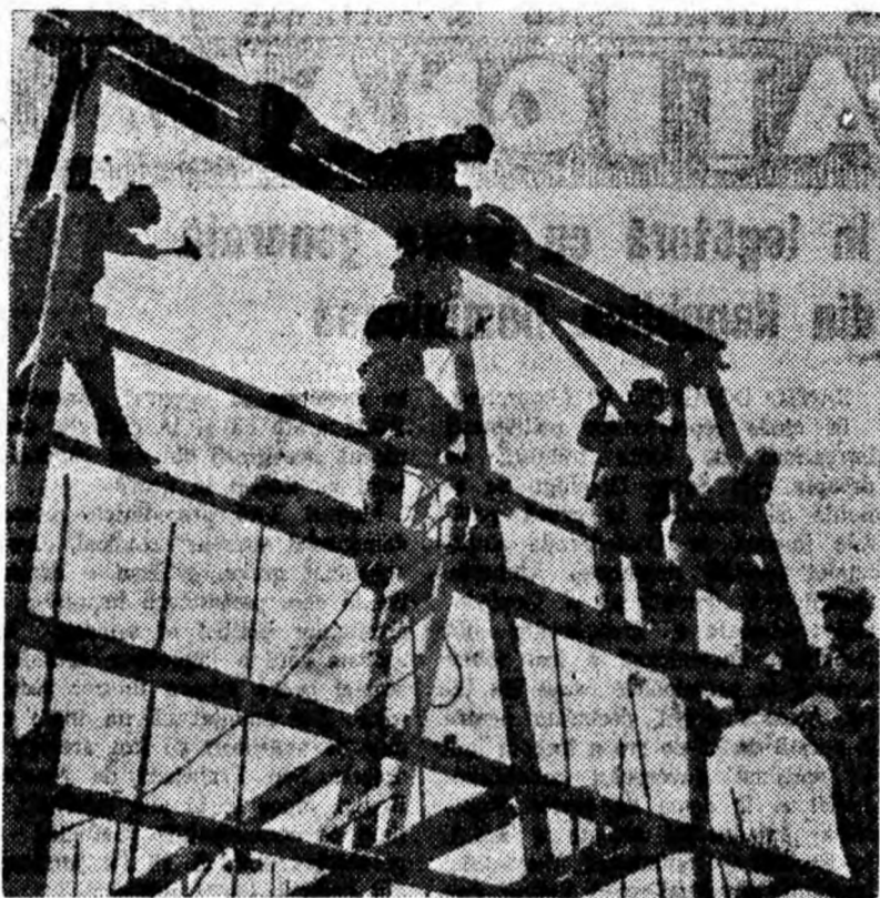
Brigada de lăcătuși condusă de Nicolaescu Miron de la T.C.M.C., montează instalația de troliu pentru ridicarea betonului necesar la glisarea turnului de extracție Aninoasa-sud.
