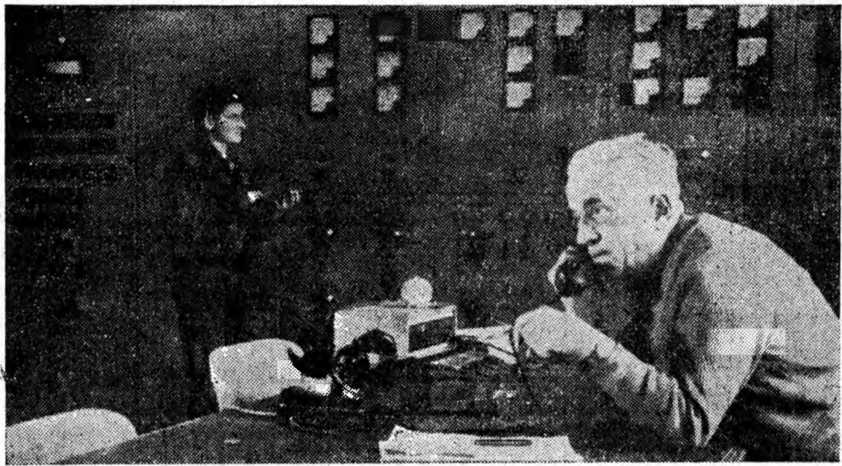
Aspect de la stația de transformare de 35/6 KV de la Petrila.
