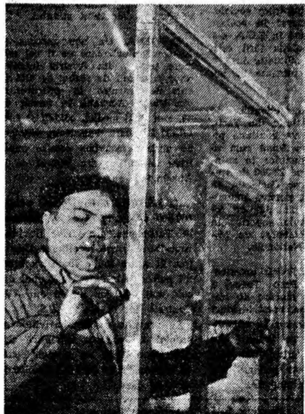
Nemeș Vasile de la I.P.I.P. Livezeni conduce o echipă de lăcătuși. Echipa sa execută confecții metalice pentru șantierul de locuințe. Iată-l în fotografie lucrînd la confecționarea unei ferestre metalice.
