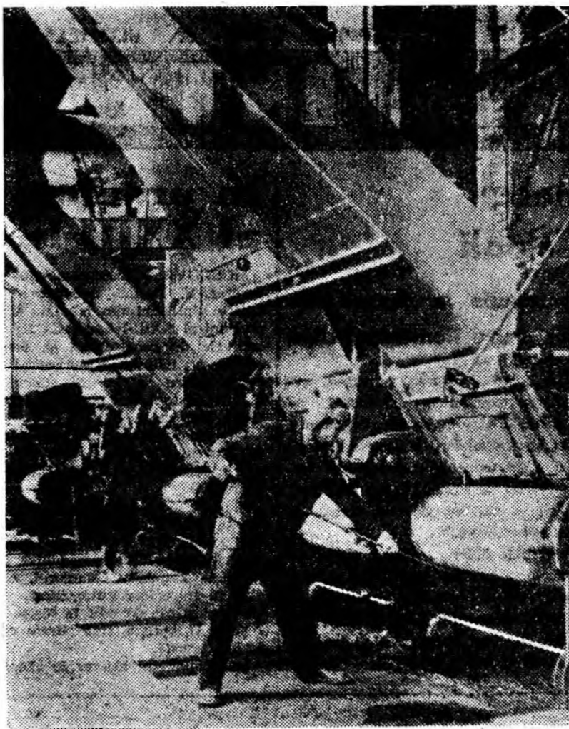
In cadrul preparației Lupeni se prepară nu numai cărbune pentru cocsificare ci și... apa caldă necesară la baia salariaților minei și preparației. Iată un aspect de muncă din sala cazanelor de apă caldă.
