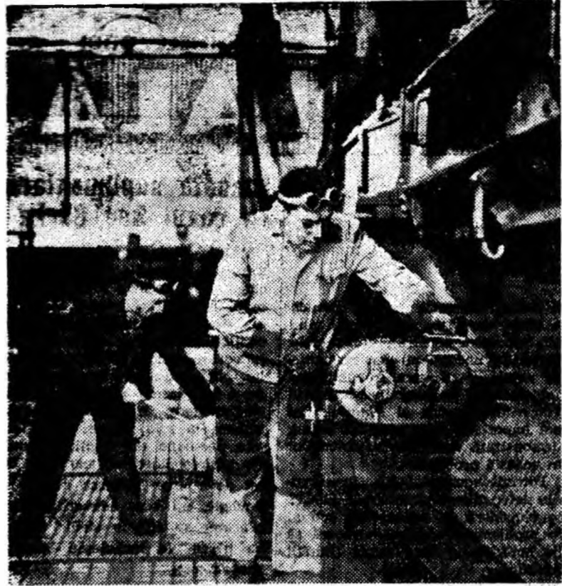
Fochistul principal Barbu Nicolae de la uzina electrică Petroșani, se numără printre cei mai conștiențioși muncitori de la această unitate. Iată-l supraveghind funcționarea instalațiilor cazanului.
