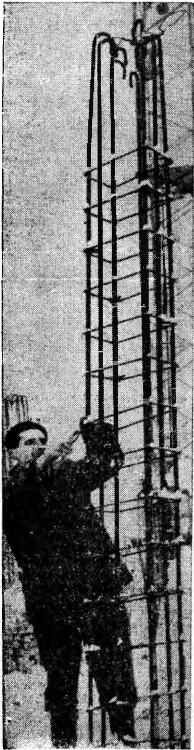
ARMĂTURILE CONSTRUCȚIILOR NOULUI AN... La construcția complexului administrativ al minei Dilja se montează armăturile metalice.
