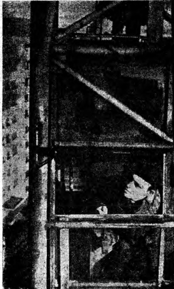
Stoica Aurică este macaragiu pe șantierul de construcții din Lupeni. Brațul puternic al macaralei manevrate de el ridică acum materiale la etajul zece al unui nou bloc aflat în construcție
