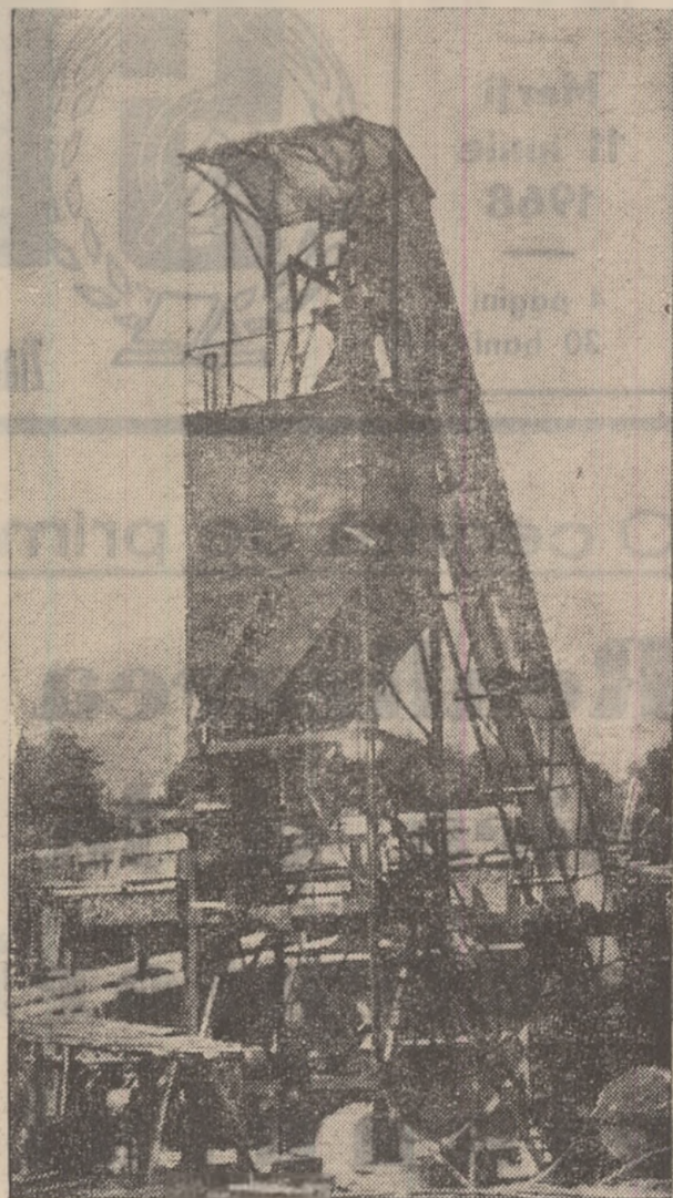
MINA URICANI. Modernă stație de betoane, necesară lucrărilor de la pulul de aeraj „vest” al exploatarei.
