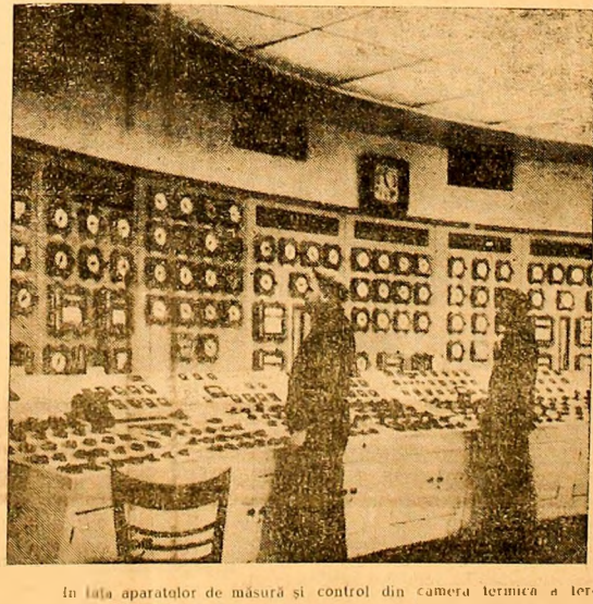
În fața aparatelor de măsură și control din camera termică a termocentralei Paroșeni.
