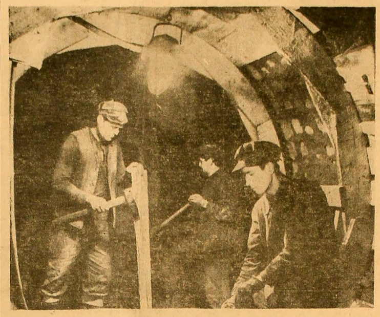
E. M. Lupeni: Șeful de schimb Marin Butoi, ajutorul miner Ion Hegyes și vaconetarul Valentin Dănășel din brigada condusă de Pavel Mihai surprins de obiectivul efectuând o lucrare de betonare la stația trafa.
