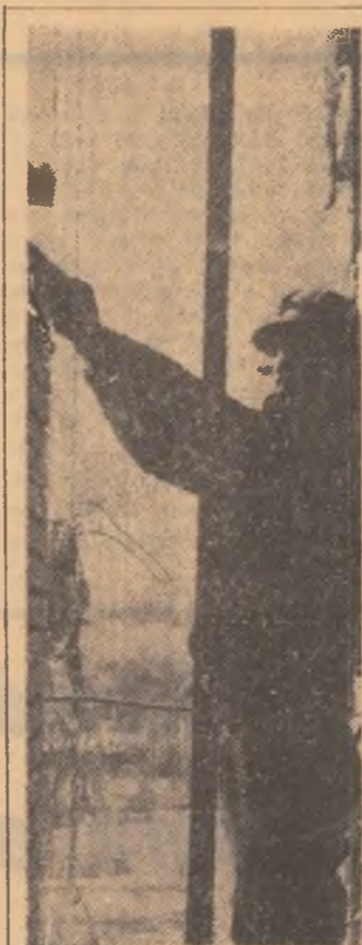
Unul din harnicii zidari din echipa condusă de Dumitru Postolache de la T.C.H. sectorul Livezeni este și Ion Telesa pe care l-am surprins pe schela u- nui nou bloc de locuințe.
