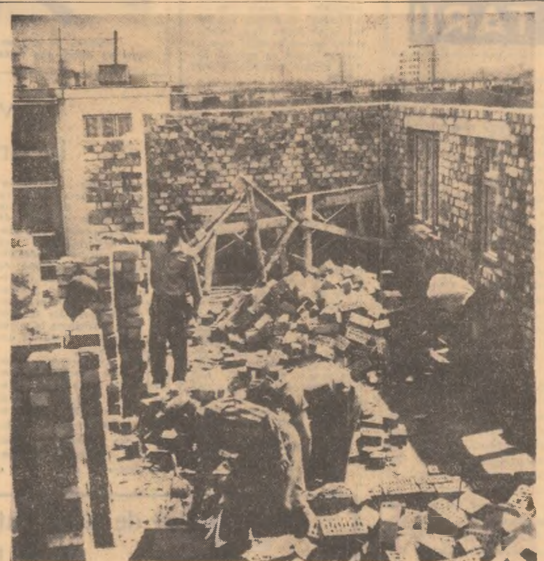
Doză zile — aceeași este avansul în timp cu care zidarii din brigada condusă de Marin Ișnăț de la lotul T.C.H. Petrița au atins cota finală a blocului P 2 tronsonul A din zona vestică a cartierului 8 Martie din Petrița care e în continuă extindere.
