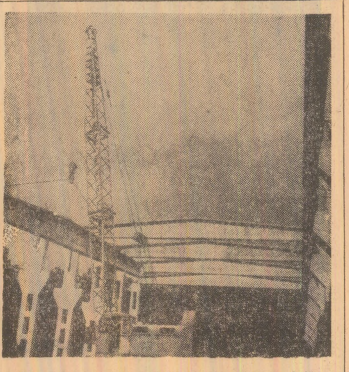
Montajul elementelor prefabricate la viitoarea hală a I.U.M.P. avansează într-un ritm rapid.
