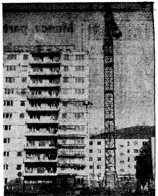
Blocul L-1 din cartierul Aeroport Petroșani se află la finisarea exterioară. Foto: Ion LEONARD
