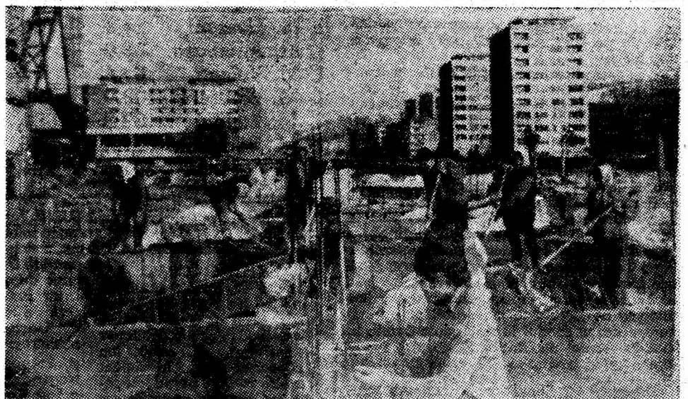
Santierul de construcții Vulcan. Echipa de betonisti, condusă de Gheorghe Stochiță și Marieta Vrînceanu consolidează fundația primului bloc, nr. 1, cu 96 de apartamente și magazine la parter. Blocul va face parte dintr-un nou microcartier ce va constitui noul centru civic al orașului.
