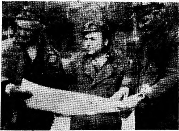
Uricani. Inginerul Constantin Călătoru, împreună cu dulgherii șefi de echipă Ion Călina și Eftimie Lanăși, consultă „pe teren” planul viitorului bloc 17 din cartierul Bucura. Foto: Gh. OLTEANU
