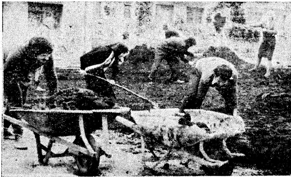
Se pregătesc rondurile pentru flori și zona verde din fața blocului K3 din Lupeni. Foto: O. GEORGE
