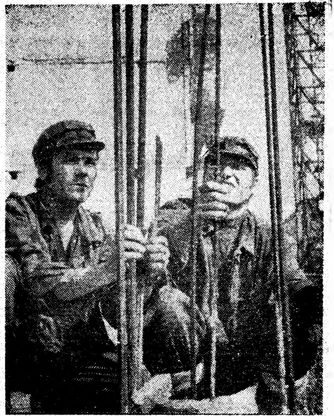
Terar-betonistii Mihai Asavei și Ion Csiki „împletesc” structura metalică la parterul blocului 69 din viitorul centru civic al Petroșaniului.
