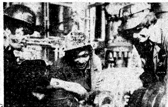
Echipa de lăcătuși condusă de comunistul Robert Navrady de la U.E. Paroșeni lucrind la repararea unei electropompe. Reparațiile executate de această echipă sînt întotdeauna de bună calitate și efectuate înainte de termenul planificat.
