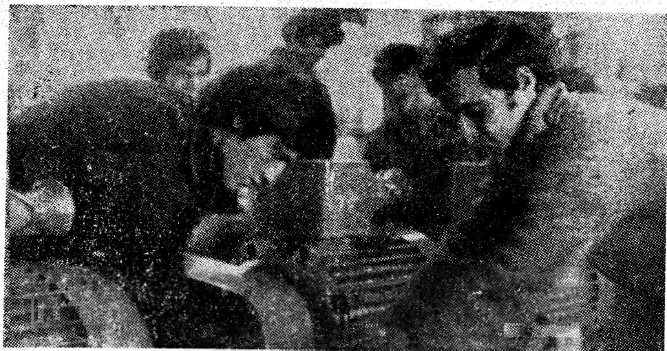
Echipa de montaj condusă de Ion Jina de la S.S.H., formație ce se bucură de o binemeritată apreciere în cadrul secției.
