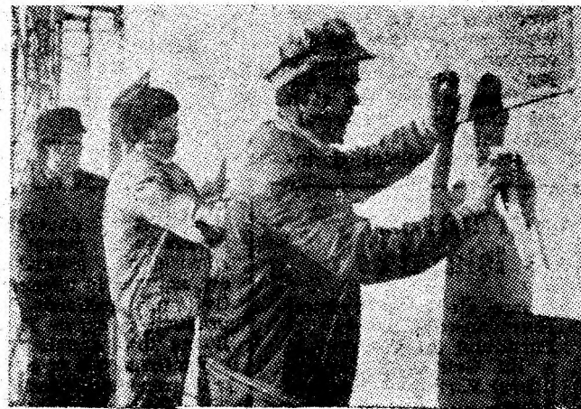
Una dintre brigăzile de zidari care și-a făcut un bi- nemeritat renume : cea condusă de Dumitru Postolache de pe șantierul 1 Petroșani al T.C.H.
