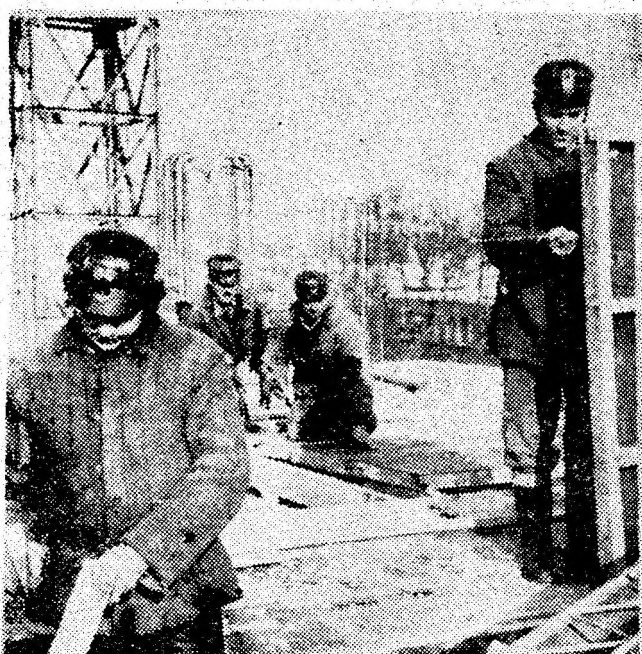
Echipa de dulgheri condusă de Ion Dobre, de la I.C.M.M. pregătește planșeul la cota 12 a noii parații de la Petrila.
