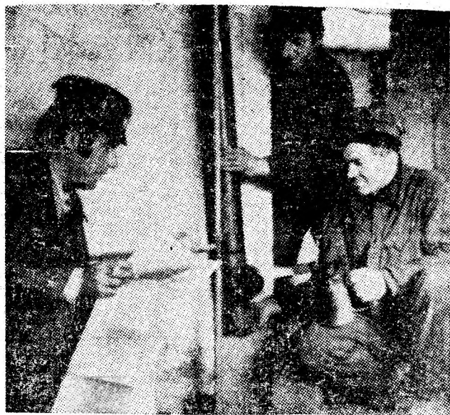
Instalatorii Tudor Coman și Gheorghe Pruteanu din brigada complexă condusă de Constantin Tenciu sub atenta îndrumare a maestrului instalator Nicolae Hristea execută instalația sanitară la blocul 47 tronsonul B din Petroșani. Foto: I. LICIU
