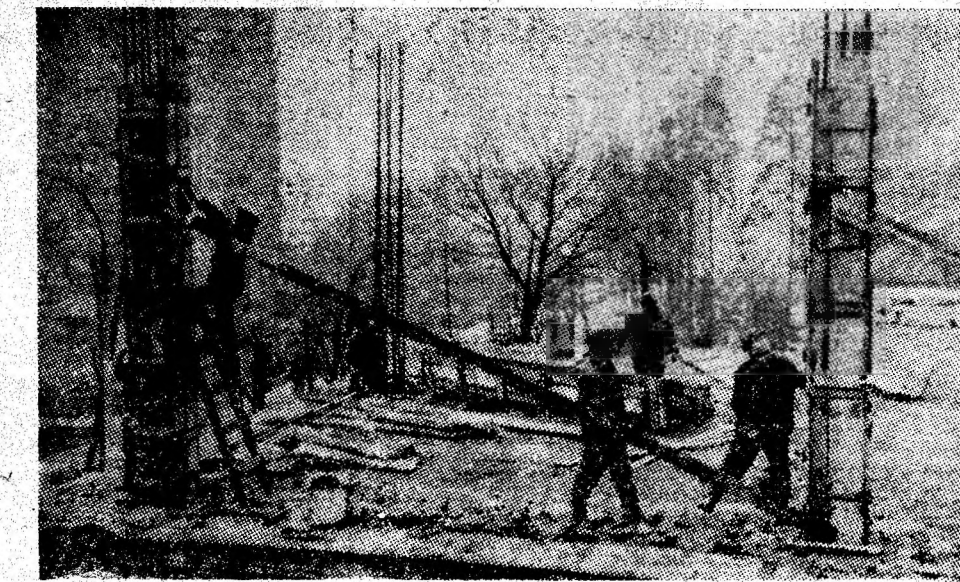
Echipa de fierar-betonisti și dulgheri, condusă de Alexandru Kiss, lucrează la montarea cofrajelor pentru turnarea betonului la structura de rezistență a viitoarei tipografii din Petroșani. Foto: Șt. NEMECSEK
